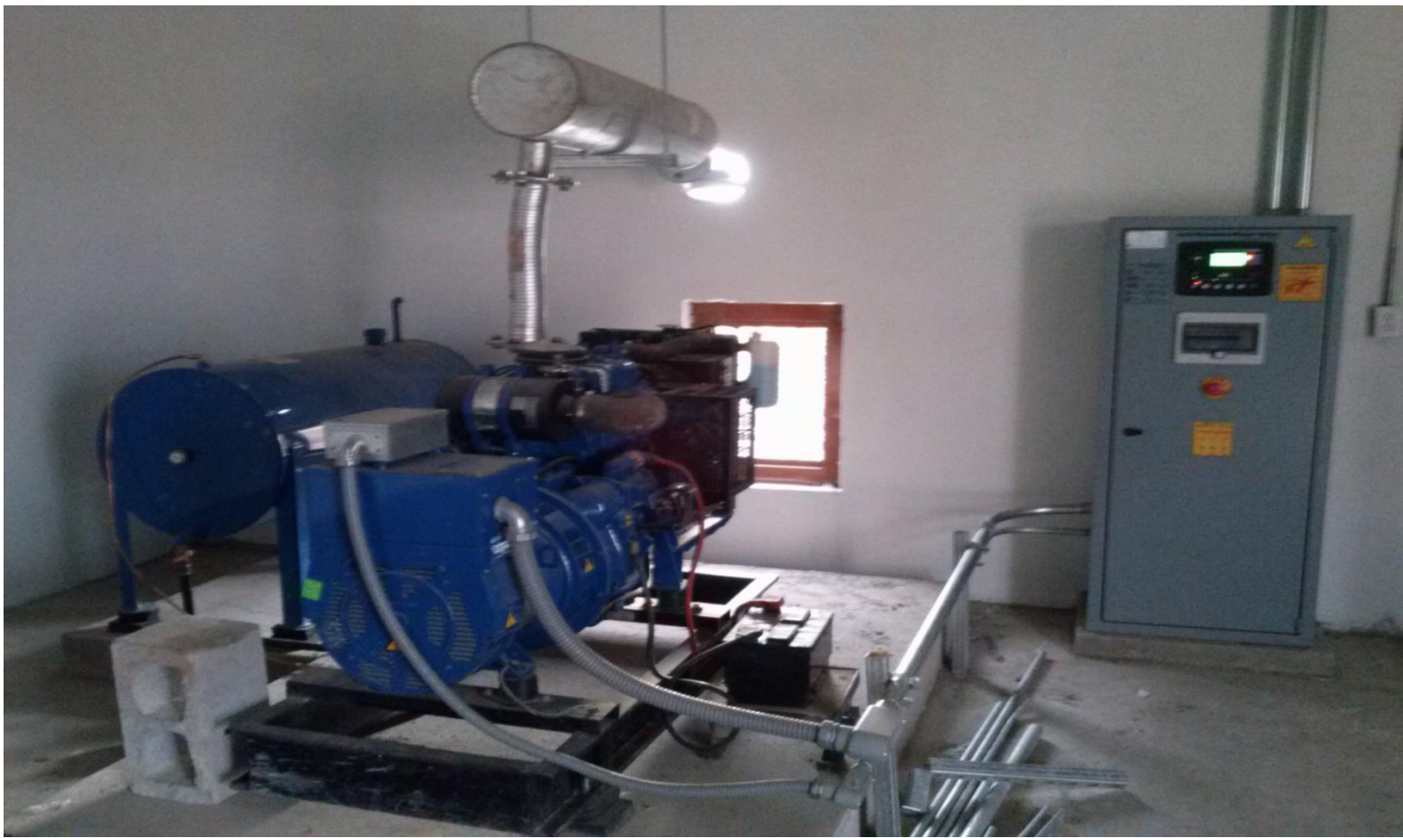
Sistema contra incendio.
